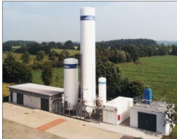
Abb. 7 Kryogene Stickstoffanlage für 620 Nm 3 /h N 2
